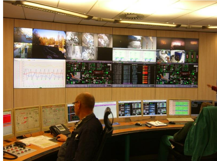
Bild 2: Blick in den Kontrollraum der Verwertungsanlage
